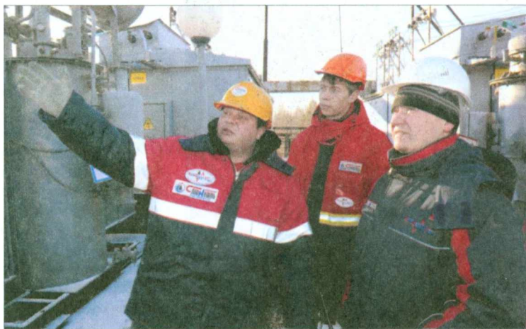
Ежедневный осмотр энергооборудования — одна из основных задач специалистов сетевого района № 1
